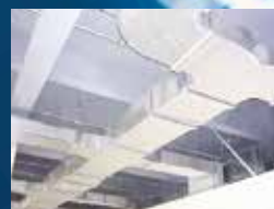
Air ducts Canalizzazioni
